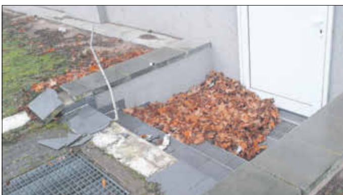
Beschädigter Eingang Sporthalle Güsen
